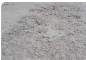
Bề mặt bê tông chưa đạt
