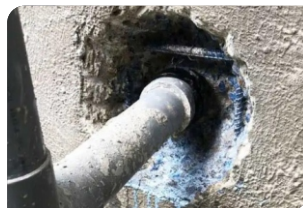
- Vệ sinh, quăn thanh trường nở - Quét chất kết nối Revinex (pha với nước theo tỉ lệ 1:4)
