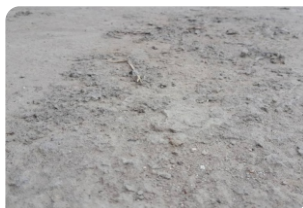
Bề mặt bê tông chưa đạt
