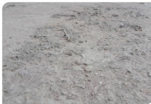
Bề mặt bê tông chưa đạt
