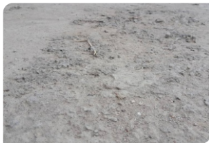
Bề mặt bê tông chưa đạt
