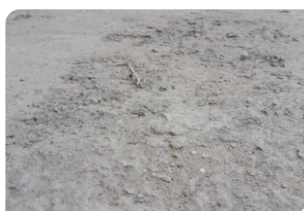
Bề mặt bê tông chưa đạt
