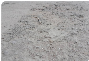
Bề mặt bê tông chưa đạt
