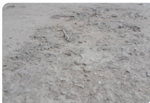
Bề mặt bê tông chưa đạt
