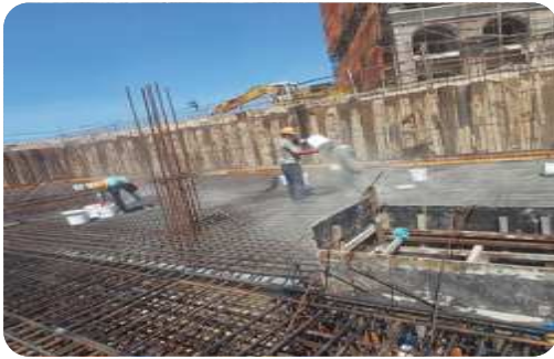
Thi công rắc vật liệu tinh thể thấm thấu Neopress® Crystal Định mức : 2,3 - 3,0 kg/m 2
