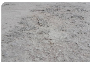
Bề mặt bê tông chưa đạt
