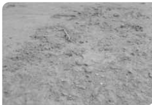
Bề mặt bê tông chưa đạt
