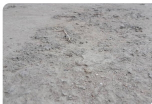
Bề mặt bê tông chưa đạt
