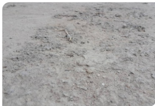
Bề mặt bê tông chưa đạt
