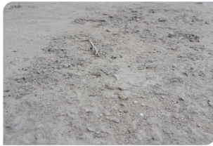
Bề mặt bê tông chưa đạt
