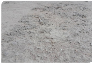
Bề mặt bê tông chưa đạt
