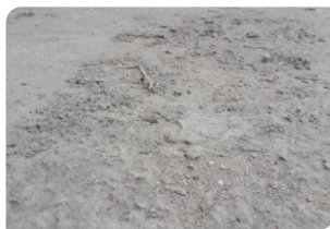
Bề mặt bê tông chưa đạt
