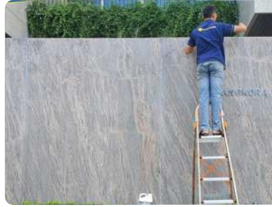
Bước 2: Thi công lớp thứ 2 Silimper® Nano sau khi lớp thứ nhất thi công được 24 giờ. Định mức: 0,1-0,2 lít/m 2
