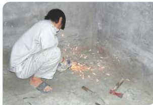
Bề mặt bê tông chưa đạt
