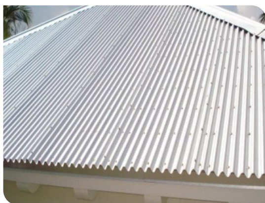
Bề mặt lớp lót
